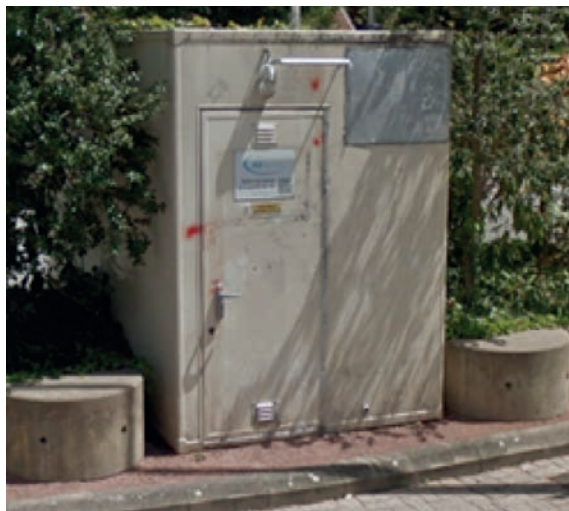
Station de mesure de Roanne - Air Rhône-Alpes
